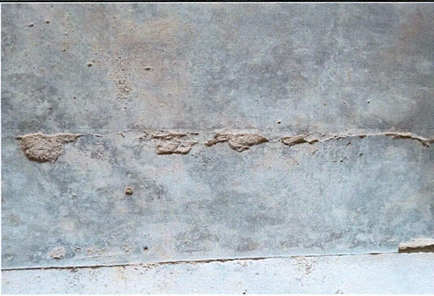
Foto 3: Estado del piso
