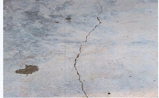
Foto 2: Estado del piso
