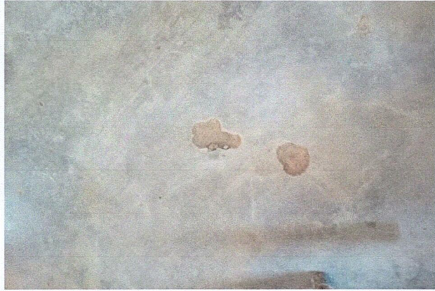
Foto 1: Estado del piso
