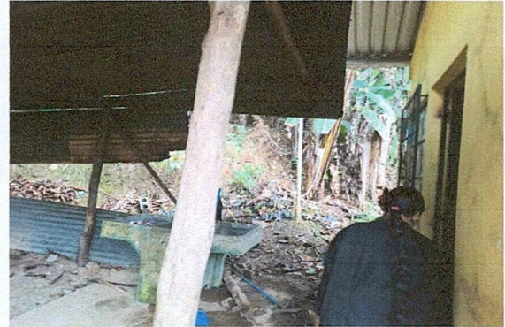
Foto 2: A si se encuentra la instalación de la Cocina
