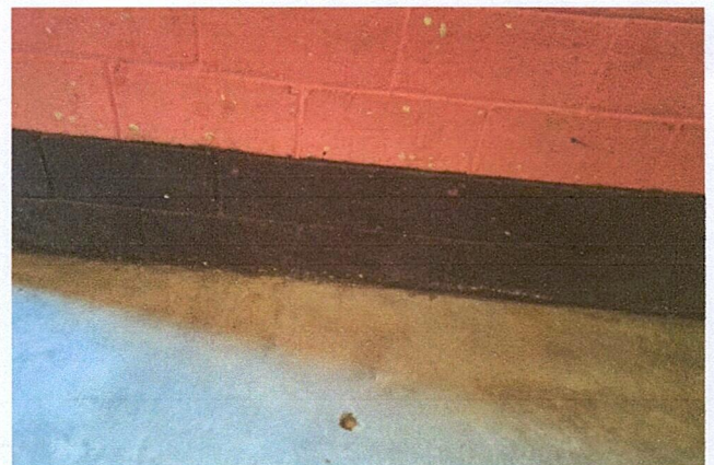
Foto 4: Estado del piso.
